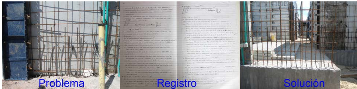
Figura No. 10. Imágenes sobre la importancia de la articulación entre las observaciones a problemas, la elaboración del libro de obra, y la gestión de la solución Fuente: Practicante Yeni Paola Granados Avila. Edición Equipo de la Coordinación de Práctica Empresarial.
