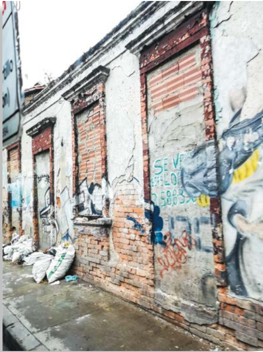
Fotografía 3. Deterioro del sistema de espacio público, edificaciones y monumentos.
