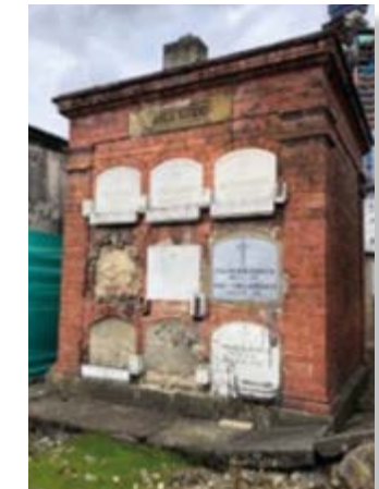
Fotografía 2. Se evidencia un deterioro físico en los mausoleos del Cementerio Central. Fuente: Mateo Barón Chaves
