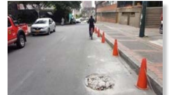
Fotografía 2. Se identifica deterioro en la malla vial y falta de infraestructura para la movilidad en bicicleta. Se puede observar al peatón en la calzada vehicular, ya que el espacio vehicular es ocupado para el uso de estacionamiento de vehículos.
